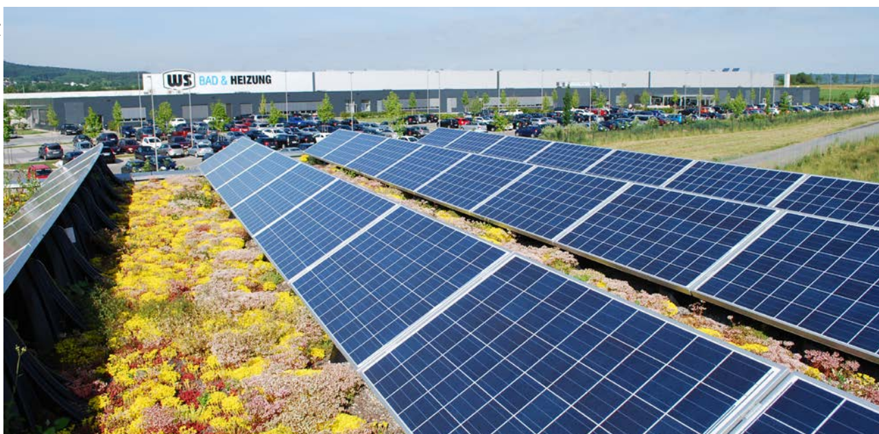
Fot. 2. Połączenie dachu zielonego z panelami fotowoltaicznymi podnosi efektywność instalacji solarnej
