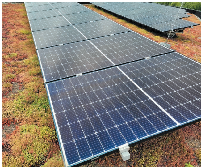
FOT. 1. Połączenie fotowoltaiki i dachu zielonego; fot.: Piotr Wolański, APK Dachy Zielone
