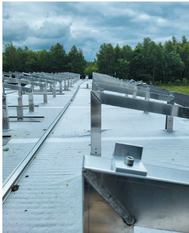
FOT. 3. Dach biosolarny w trakcie montażu; fot.: Piotr Wolański, APK Dachy Zielone
